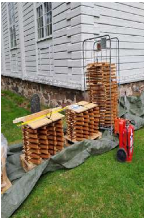
Paanut odottavat asennusta.
